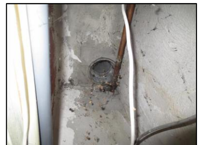
Photo N° 885 AMIANTE CIMENT -- PLACARDS GAZ +2 Gaines & coffres verticaux Ventilation haute (Fibres-ciment)
